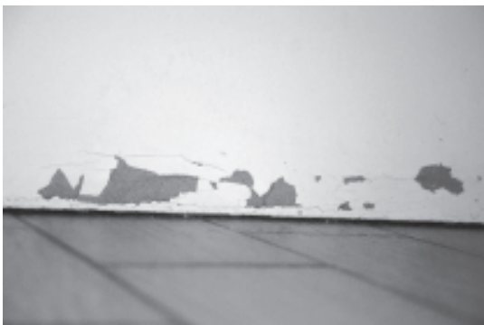
Afb. 6 Zwelling en beschadiging van de onderkant van houten Rf-deuren door langdurig contact met kuiswater.
