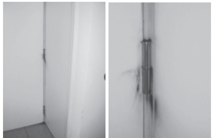
Afb. 8 Vervuiling door slijtage van het scharnier, te wijten aan een gebrek aan onderhoud.
